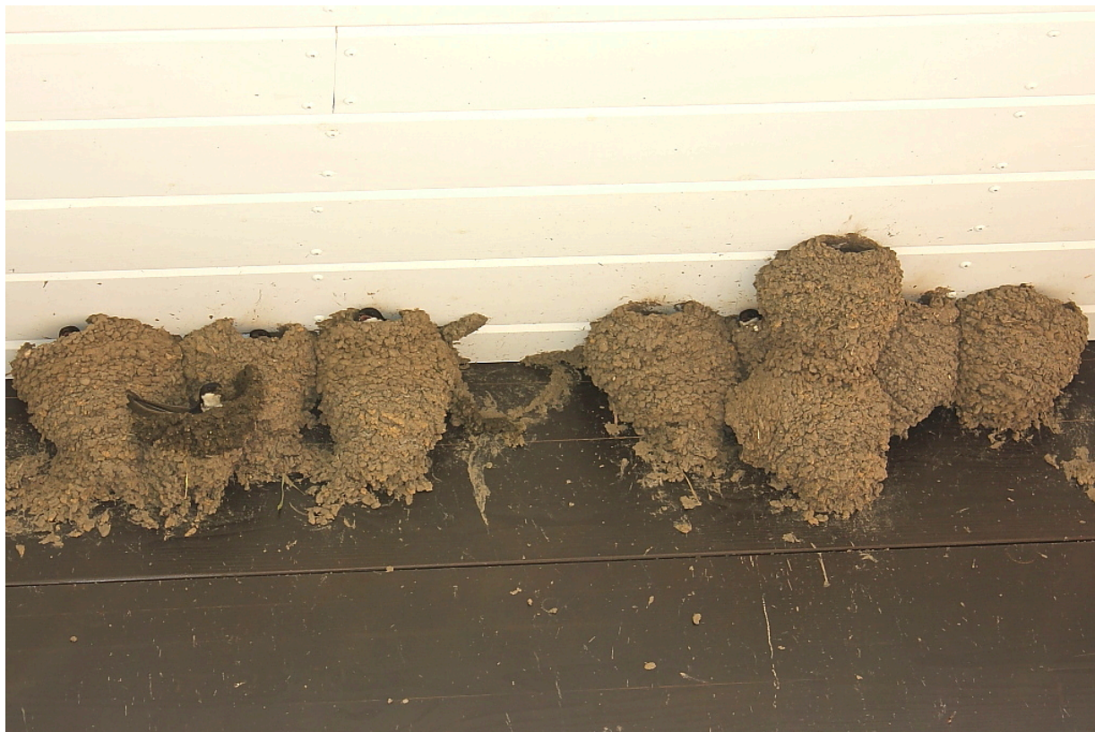
Рис. 26. Фрагмент здания Беседки с гнездами воронок. 9 июня 2019 г.
